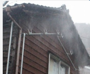
固定型ドレンチャー式
